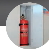
Automatic fire extinguishing system Automatický hasičský systém
