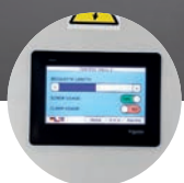
Controlled by PLC Řízeno prostřednictvím PLC
